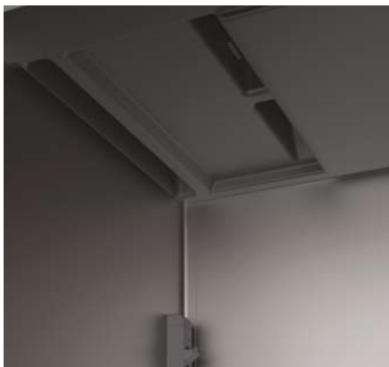
Canale aereazione | Ventilation duct
